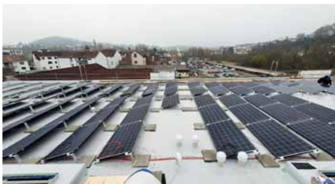
Die PVT-Wärmepumpenanlage in Eppelborn wurde im Dezember 2021 installiert und soll künftig durch ein begleitendes Monitoring überwacht werden.
