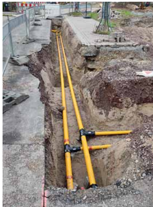
Kosten runter: Weil passive kalte Nahwärmenetze aufgrund des niedrigen Temperaturniveaus keine Leistungsverluste haben, ist eine Dämmung der Leitungen nicht erforderlich.
