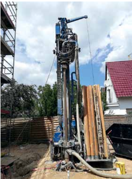
Abteufen der Bohrlöcher: Rund einhundert Meter tief unter der Erdoberfläche hat der Untergrund ganzjährig eine Temperatur von etwa 10 bis 12 °C – ideal für das Prinzip der kalten Nahwärme.
