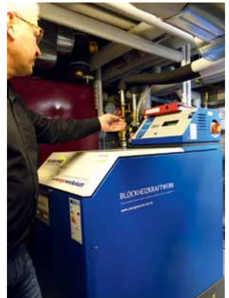
Blockheizkraftwerk (BHKW) Typ ASV 21, Fab. Energiewerkstatt, mit 43 kW thermisch, 20 kW elektrisch, betrieben mit Flüssiggas. Nach der Amortisationszeit von 10–15 Jahren ist eine Umstellung auf ein Wasserstoff-BHKW geplant.
