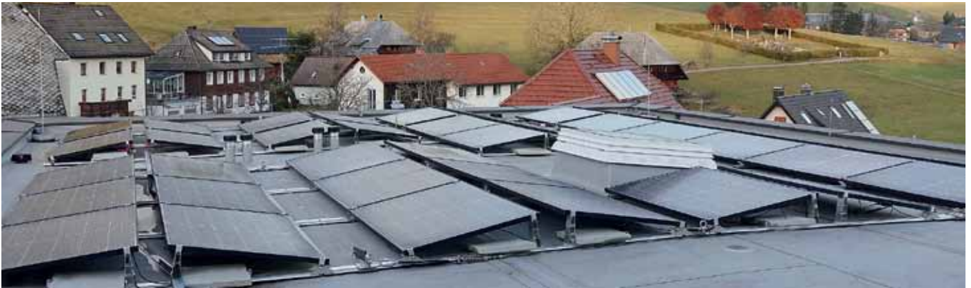
PV-Anlage mit 15 kWp auf dem Neubau. Auf den Dachflächen des Bestandsbaus werden weitere 20 kWp hinzukommen. Die jährliche Sonnenscheindauer in Waldau beträgt 1.600–1.700 Stunden.
