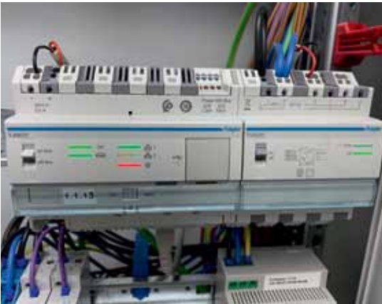
Hardware in einem der Schaltschränke für das Energiemanagement.
