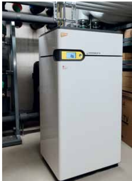
Wärmepumpe Fab. Waterkotte, 80 kW. Die Geothermie-Sonden in 160 m Tiefe liefern 10 °C Quelltemperatur. Mit 35 °C und einer JAZ von 5–6 wird im Sommerbetrieb das Schwimmbad beheizt und Warmwasser vorgewärmt.
