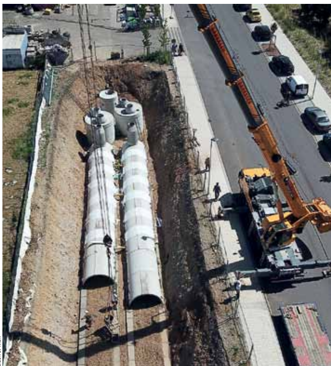
Sickeranlage Süd mit zwei Rigolensträngen. Dahinter jeweils ein Filterschacht ViaPlus und der Verteilerschacht.
