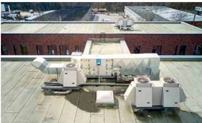
Eine Anlage der Serie D-AHU Modular P sorgt für die Belüftung des Gebäudes.
