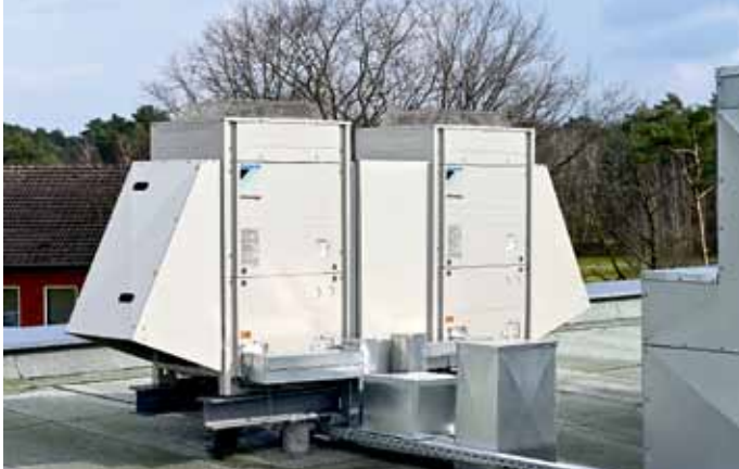
Die Wärmepumpen sind auf dem Dach des Gebäudes installiert.
