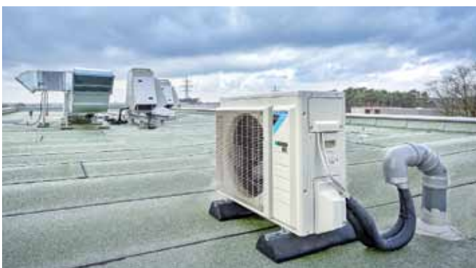
Daikin Split-Geräte auf dem Dach sorgen für die Klimatisierung des Serverraums.
