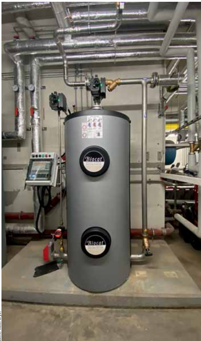
Inbetriebnahme der DVGW zertifizierten Biocat KS 5D
