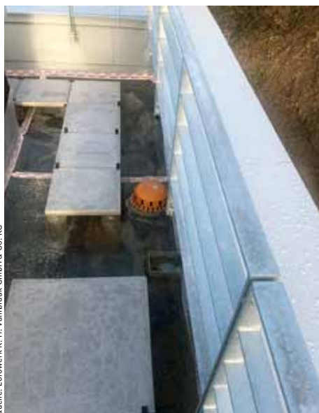
Die Notentwässerung (orangefarbene Haube) ist als Freispiegelströmung ausgelegt.
