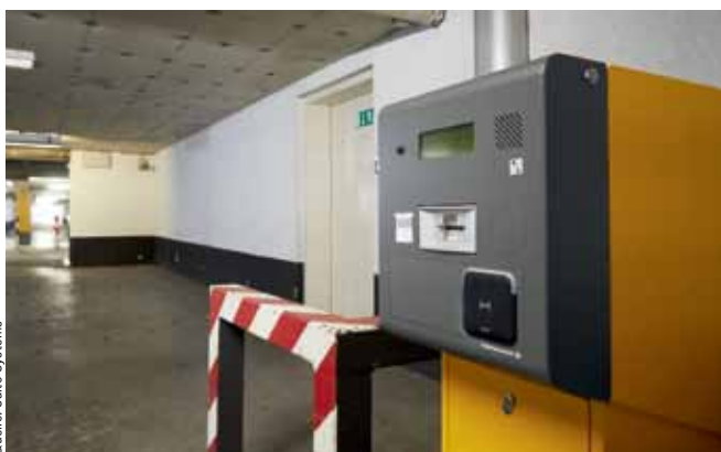
An den Zu- und Ausfahrten zum Parkhaus des Estrel Berlin sind Salto Wandleser installiert.
