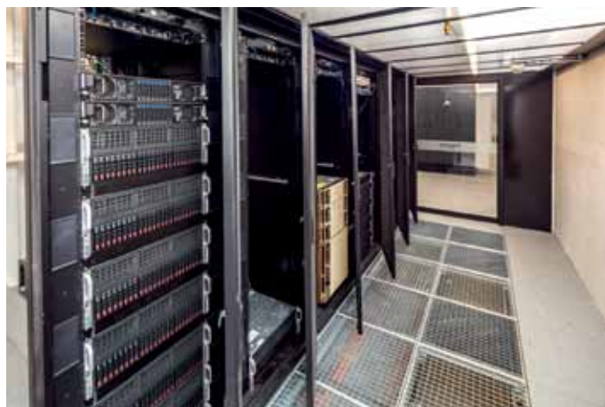
Quelle: Mitsubishi Electric
