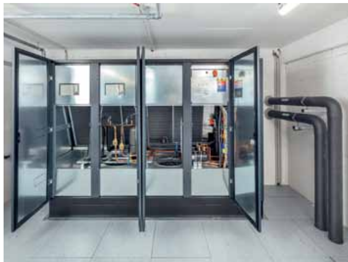
Quelle: Mitsubishi Electric
