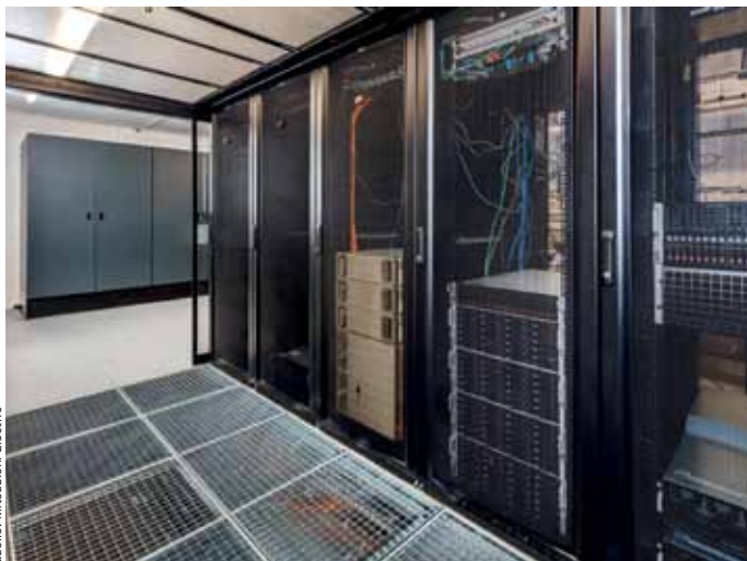
Quelle: Mitsubishi Electric
