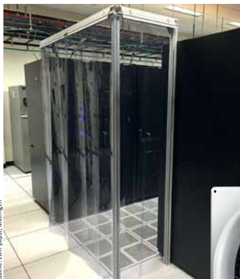
2 – Die Einrichtung von Kaltgängen sorgt für eine bessere Luftführung im Rechenzentrum.
