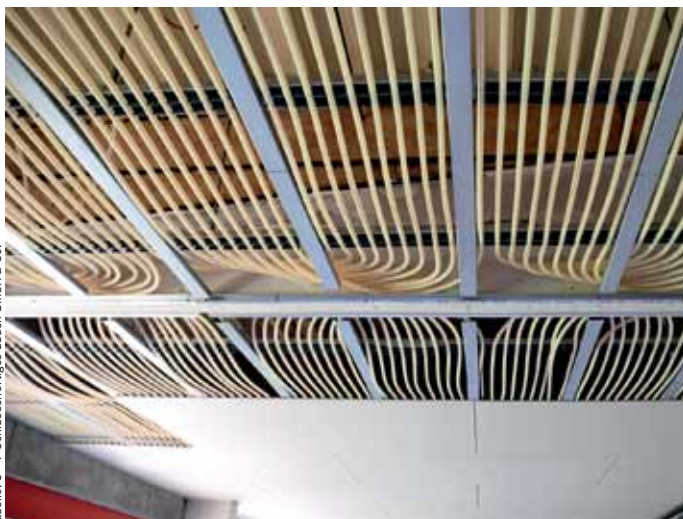
Die Komfortdecken verwandeln Raumdecken in Strahlungsflächen, die Räume im Sommer angenehm kühlen.
