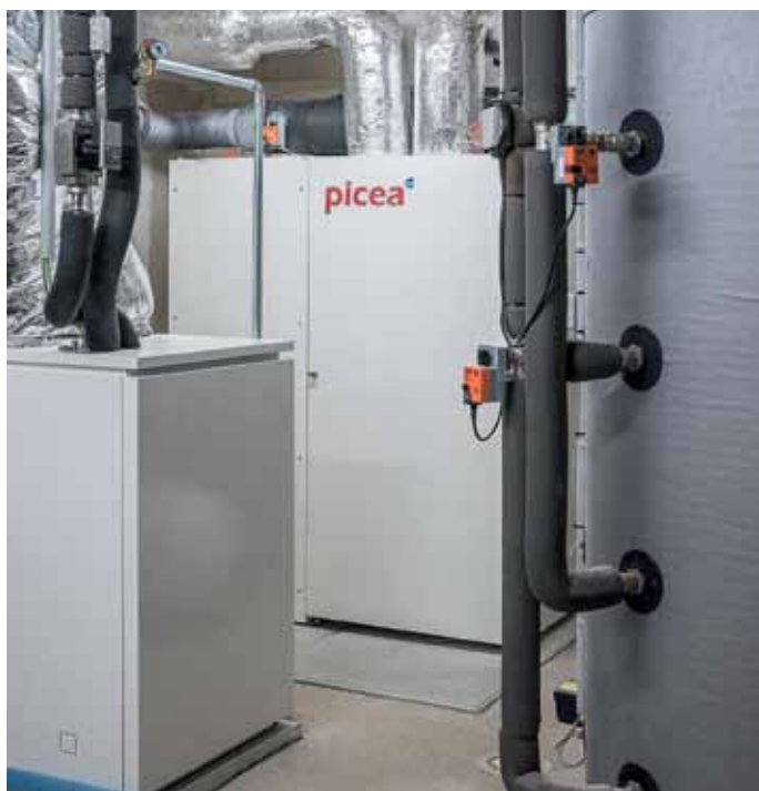
Die Energiezentrale (sie beinhaltet Batterie, Leistungselektronik, Lüftungsgerät, Elektrolyseur, Brennstoffzelle) ist untergebracht in einem kompakten Gehäuse, das 2 m 2 Grundfläche benötigt.
