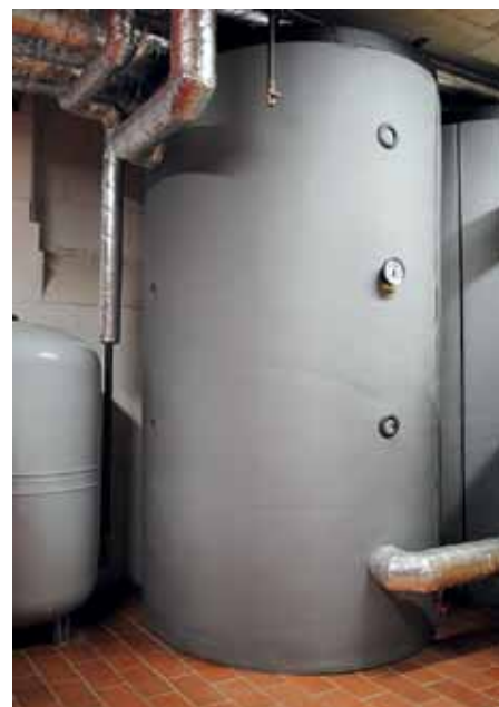
Zwei Pufferspeicher im Heizraum bevorzugen 4.000 l Wasser.
