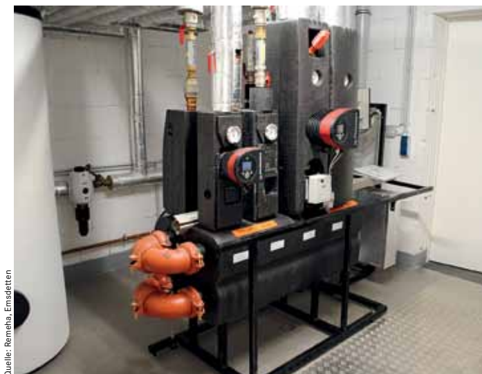
In den Häusern kamen Übergabestationen zum Einsatz, die die Wärme- und Warmwasserversorgung gewährleisten.
