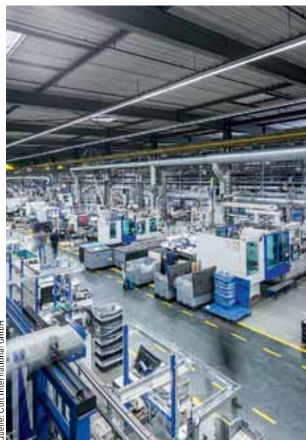
Adiabatische Kühlung und Schichtlüftung als Lösung für die hohen Temperaturen der Spritzgießfertigung
