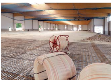
Die Roth Industrieflächenheizung im Logistikzentrum Buchenau sorgt für Wohlfühltemperaturen und trotz höchsten Belastungen.
