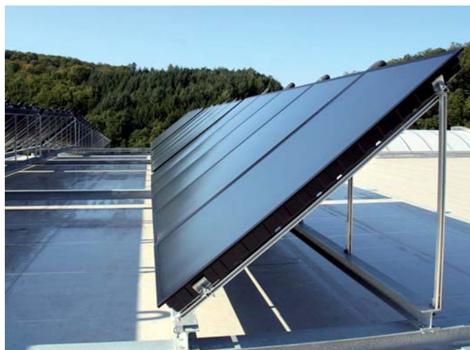
Die regenerative Energieerzeugung für Warmwasser erfolgt mit den Roth Flachkollektoren Heliostar.
