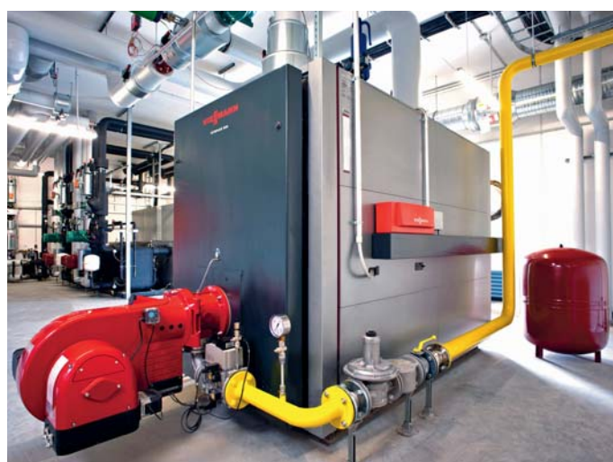
3 – Der Gasheizkessel Vitoplex 300 deckt Spitzenlasten ab.
