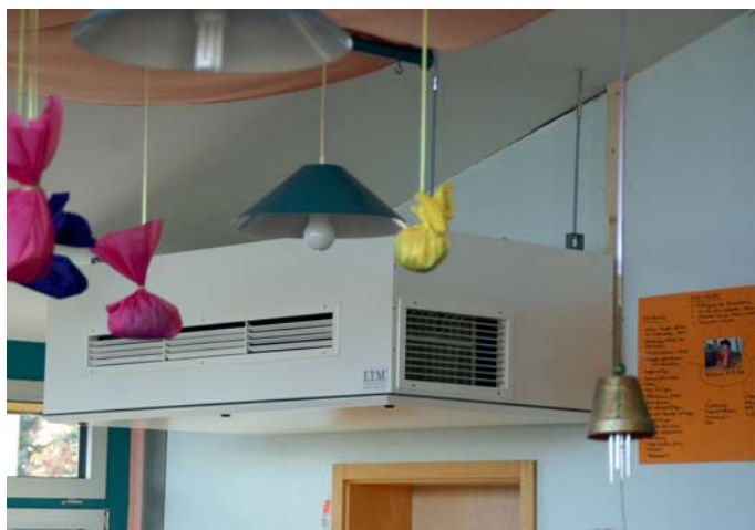
Eines der Geräte der Reihe LTM dezent 600 im Gebäude „Der gute Hirte“
