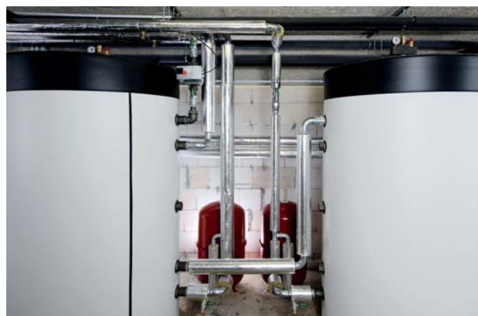
Die beiden je 1.500 l fassenden Pufferspeicher für die Warmwasserbereitung werden von der Wärmepumpe und der Solaranlage mit maximal 55 °C beladen und stellen die Energie zur Trinkwassererwärmung für die Wohnungsstationen zur Verfügung.
