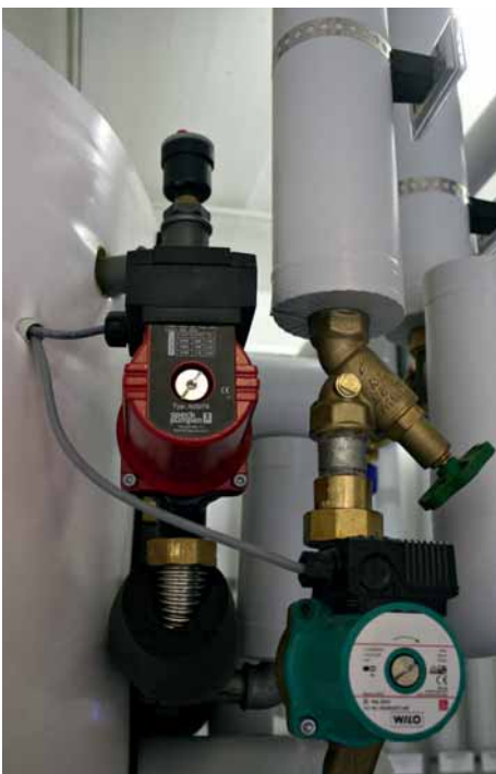
Warmwasser-Zirkulationspumpe (rechts) und Gegenstrom-Pumpe der Frischwassererwärmung im Multienergiespeicher (links)
