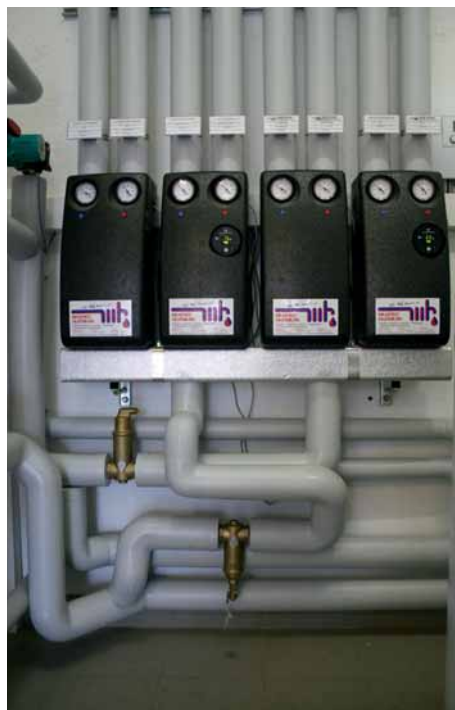
Die Heizkreisverteilung wurde vollständig neu aufgebaut und mit Luftblasen- sowie Schlammabscheider ausgestattet.
