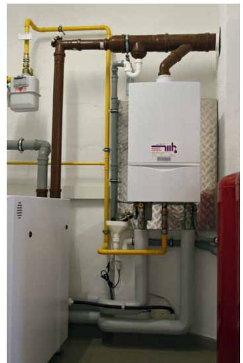
Brennwertgerät zur Spitzenlastabdeckung und gemeinsame Abgasführung mit dem BHKW.
