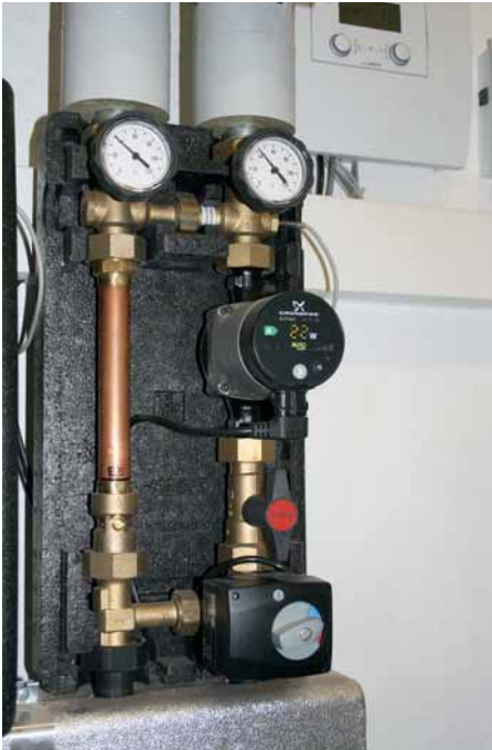
Gemischter Heizkreis mit Energieeffizienzpumpen
